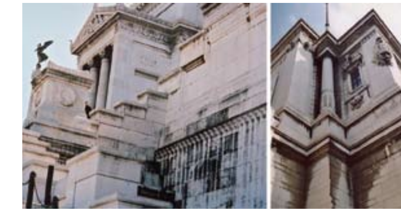
Fig. 16 - Particolari del degrado presente su tutti i prospetti del monumento e rilevabile soprattutto nelle zone particolarmente esposte all'azione degli agenti atmosferici.
